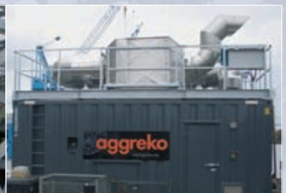
Die Aggregate mit Abgasnachbehandlungssystem verfügen über eine SCR-Unit – sie sind so aufgebaut, dass Aggregat und SCR-Einheit gemeinsam mit möglichst geringem Transportgewicht auf einem LKW transportiert werden können.
