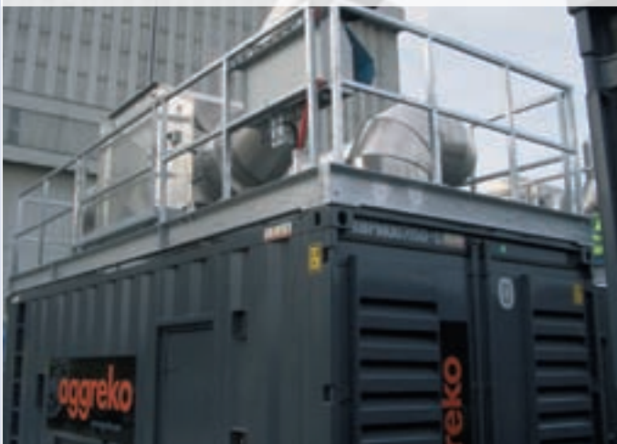
Detailansicht der Abgasnachbehandlungsanlage auf einem dieselmotorisch betriebenen Aggregat.
